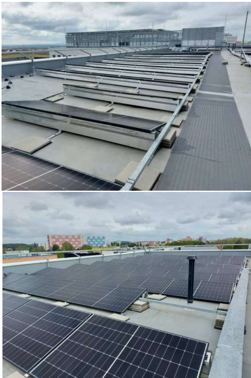
Obrázek 6: FVE na střeše EKF
