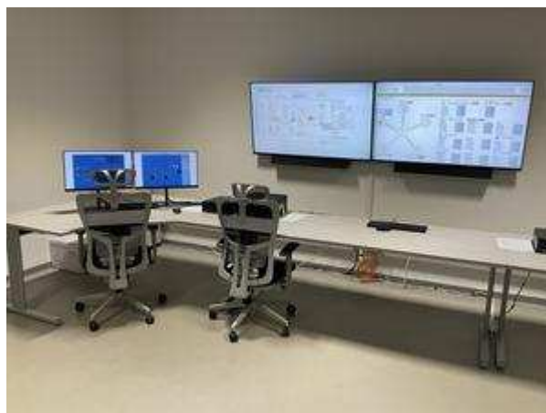
Obrázek 14: Dispečerské pracoviště MaR objektu
